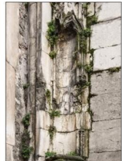
Les murs de l'église Saint-André envahis par la végétation. Photo Le DL/Clara GOUBAULT
