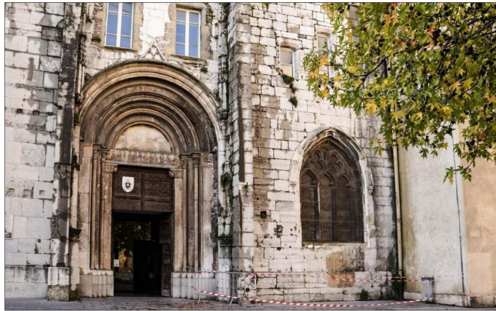
Des rubanisations ont été installées pour interdire l'accès à un mur de l'église Saint-André à la suite de chutes de pierres. Photo Le DL/Clara GOUBAULT
